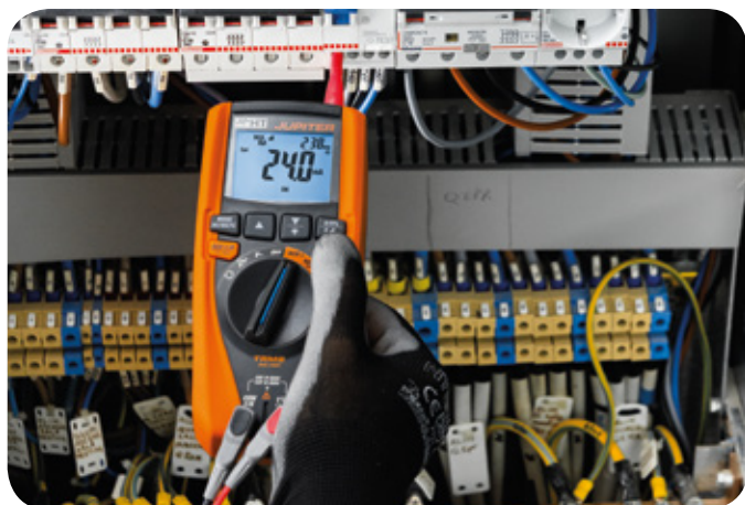
Verifica tempo e corrente d'intervento RCD.
