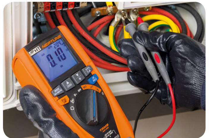
Continuità dei conduttori di protezione.
